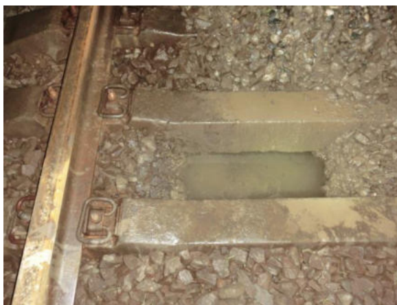
Рисунок 5.42 – Загрязненный балластный слой ж.-д. пути в тоннеле
