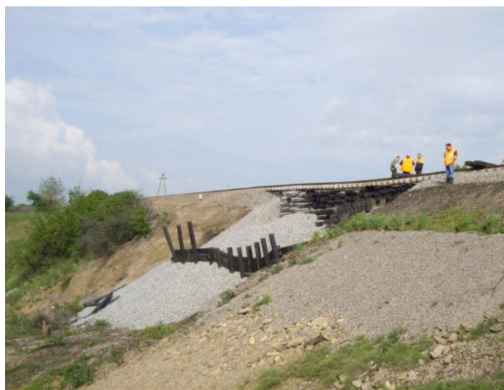
Рисунок 3.22 – Внезапная деформация высокой насыпи на 46ПК8 участка Лихая – Морозовская
