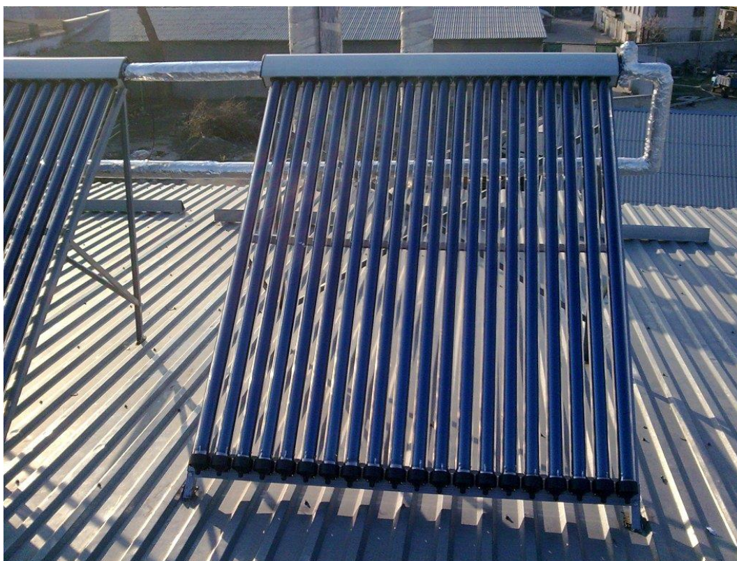
Рис. 2. 15 – Пример монтажа солнечного водяного коллектора на крыше коттеджа
