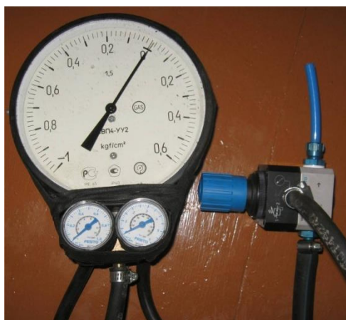
Рисунок 5.6 – Оборудование для фиксирования и регулировки давления в пневмосистеме АГРС
